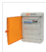
Щит управления вентилятором UM-V-R
